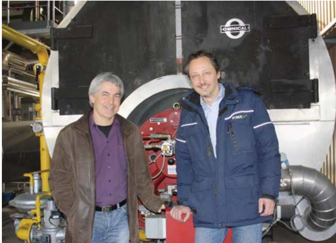
Roland Jacquérior et Daniel Claret, cofondateurs de PMAX, devant l'une des chaudières du chauffage à distance de Martigny dont ils ont optimisé l'usage pour un gain de 120 000 litres d'équivalent mazout par année. LE NOUVELLISTE
